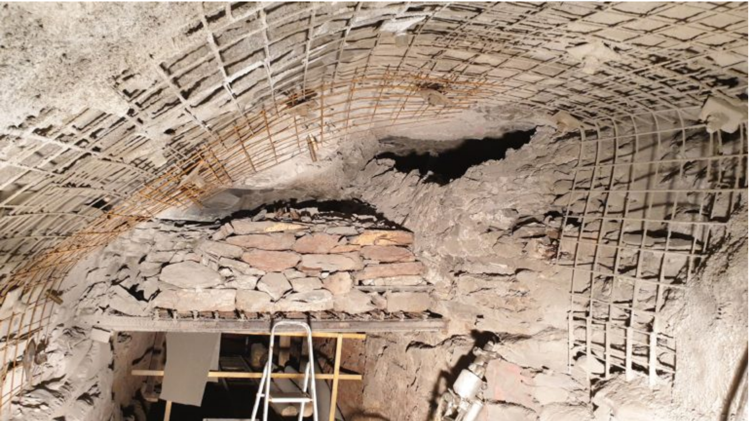
Sanierungsnotwendigkeit im Schlüsselstollen
