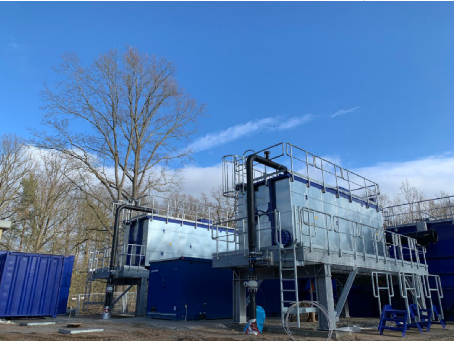
Flockungscontainer | MWBA Ruhlmühle
