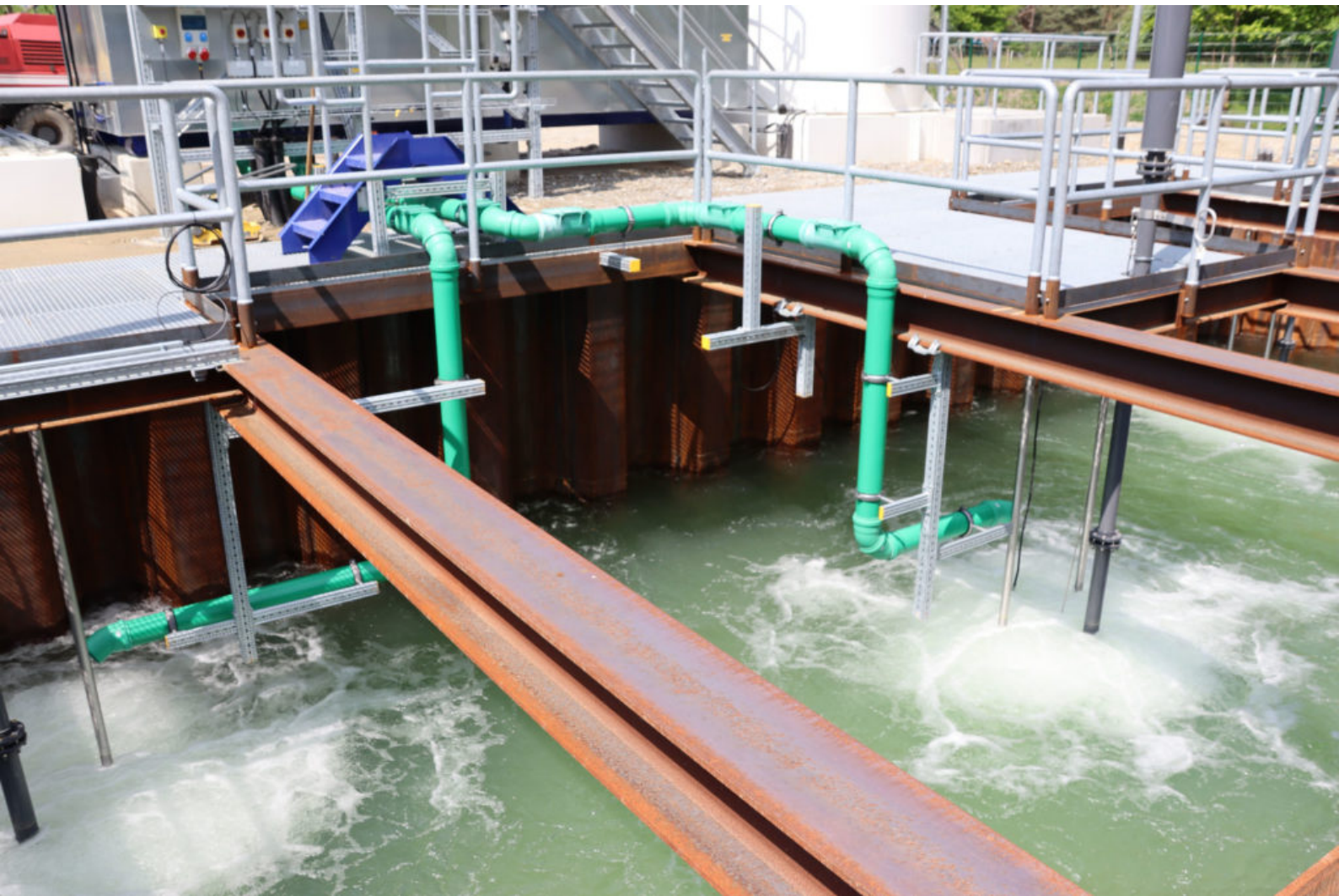
Inbetriebnahme des Reaktionsbeckens
