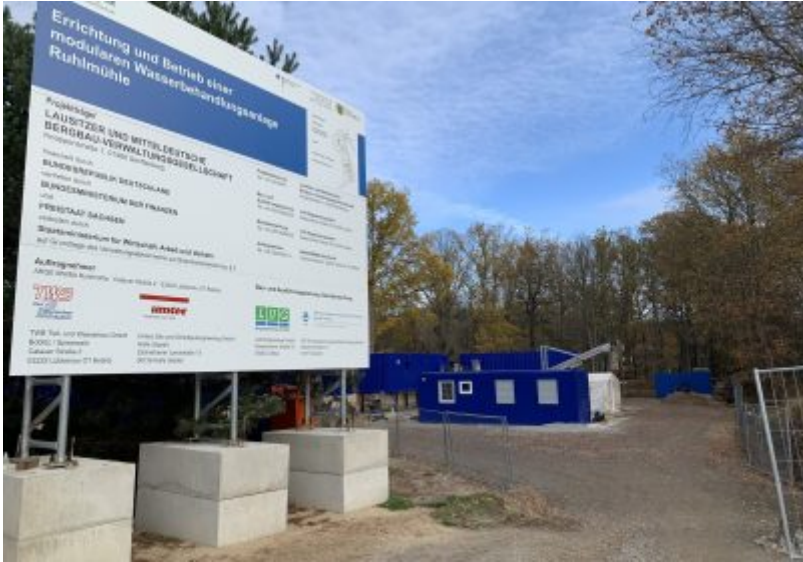
LMBV-Bautafel am Altarm der Spree
