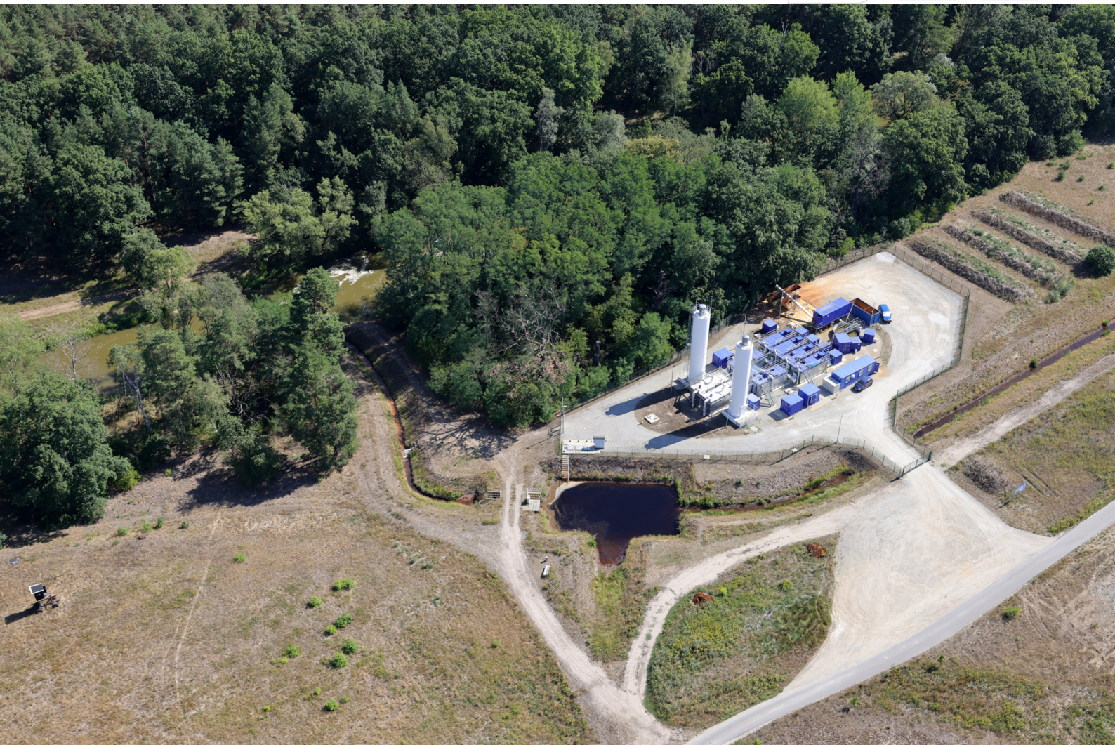
Modulare Wasserbehandlungsanlage (MWBA) Neustadt der LMBV
