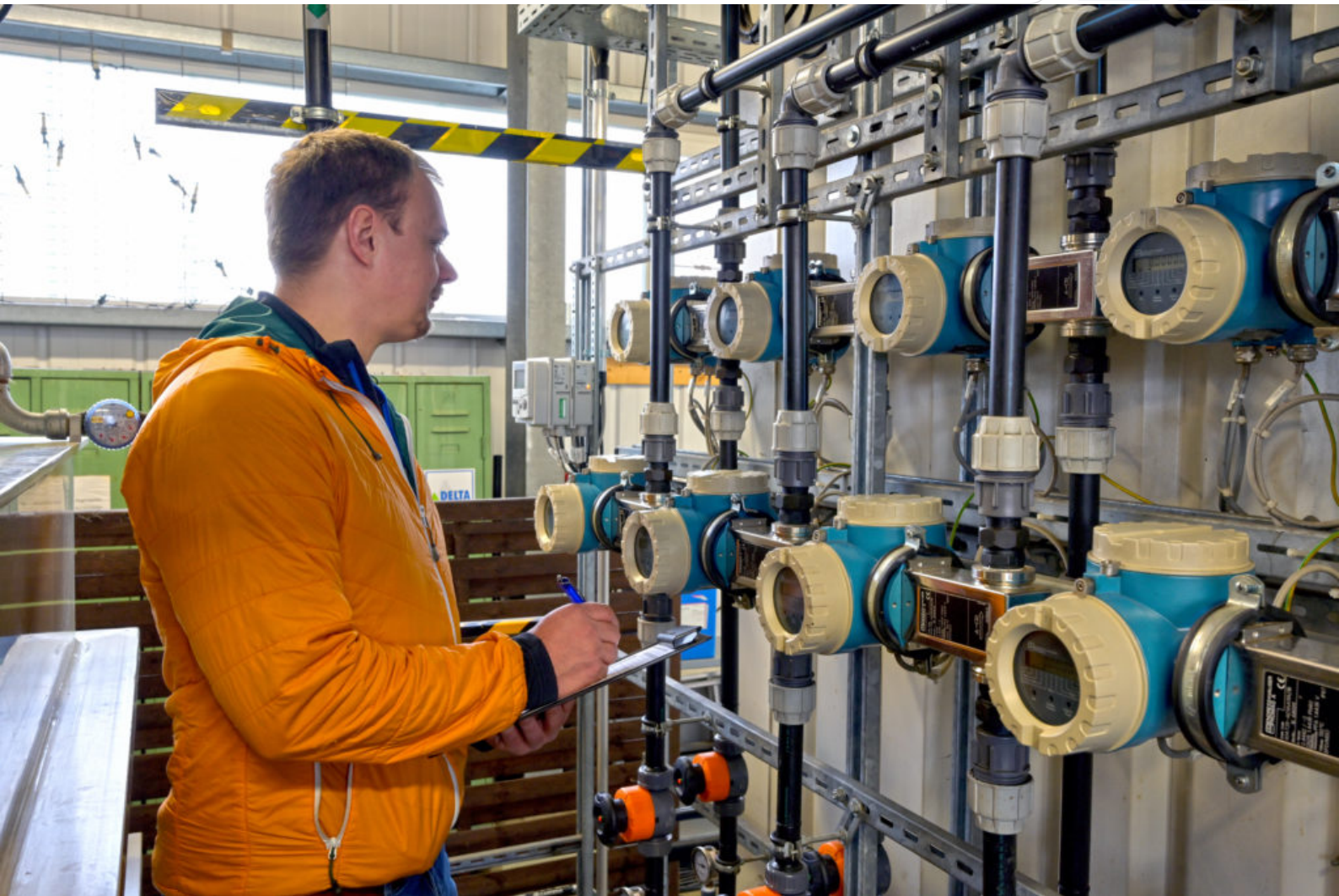
Dokumentation von Messwerten in der Grundwasserreinigungsanlage Zwickau/Schedewitz
