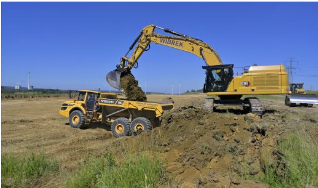
Massenbewegung in einem Sanierungstagebau der LMBV
