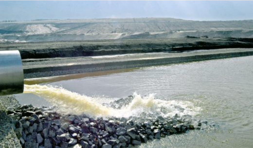
Flutungsleitung zum Großräschener See (2007)
