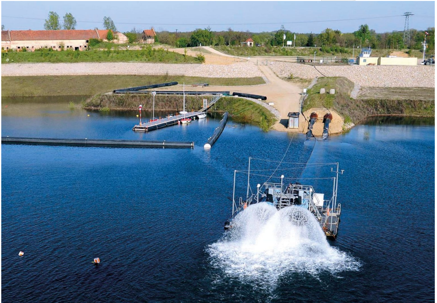
Flutungsleitung im Berzdorfer See
