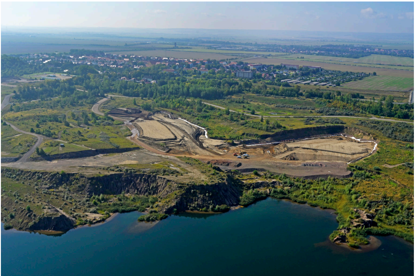
Sanierungsbereich Böschungsbewegung Nachterstedt
