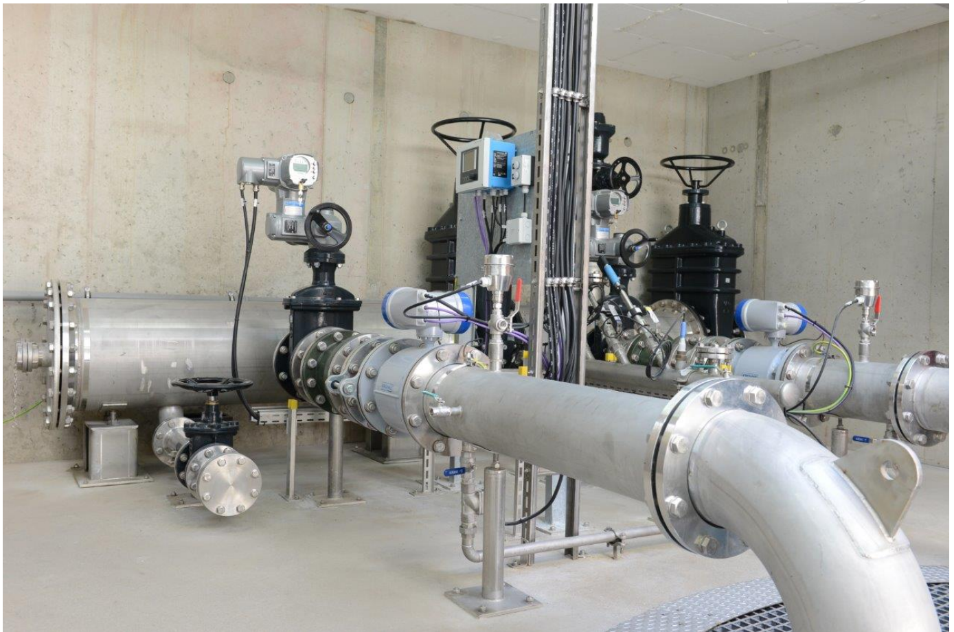
Blick in einen Horizontalfilterbrunnen
