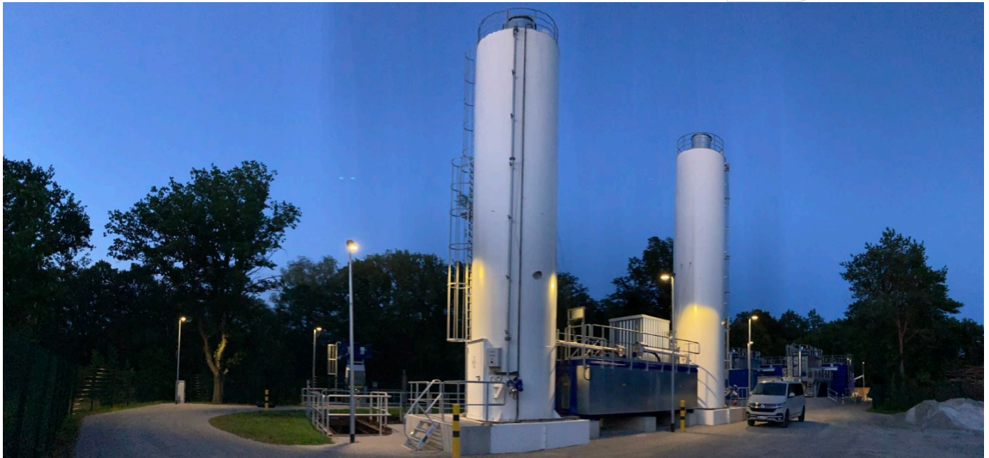
Modulare Wasserbehandlungsanlage Ruhlmühle
