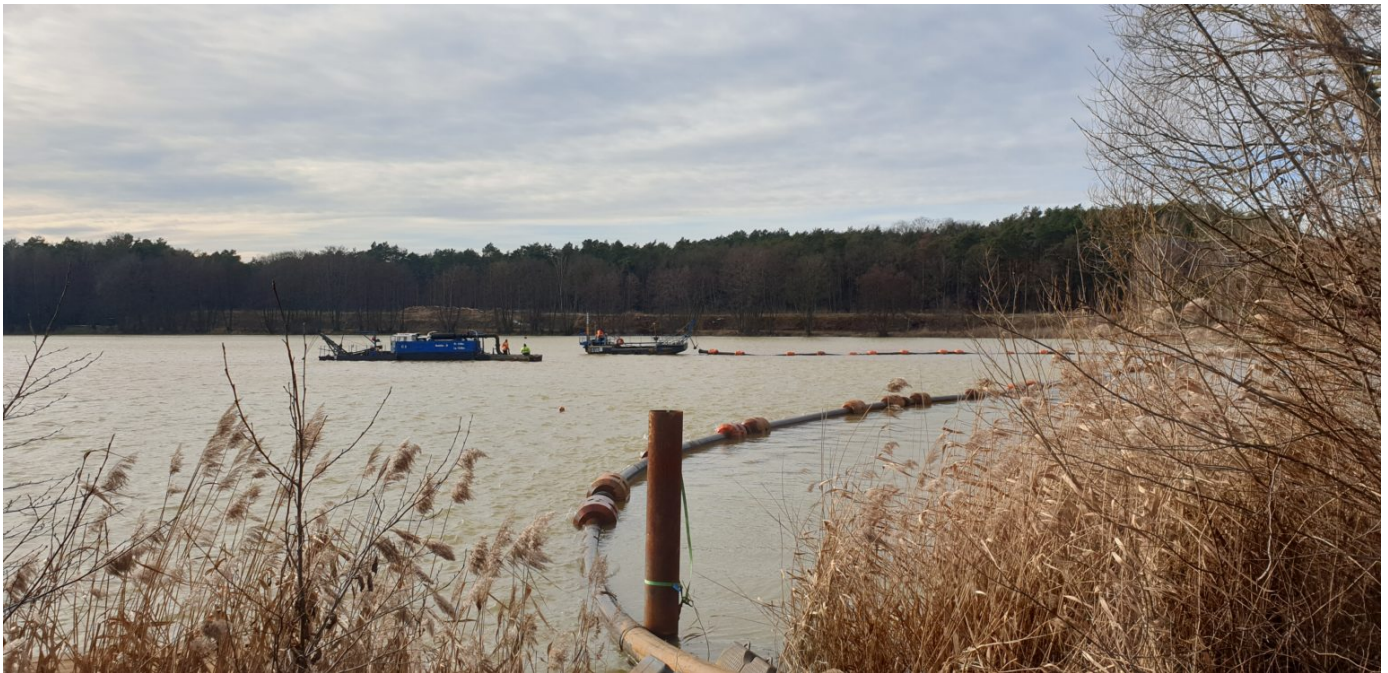
Konditionierungsanlage Vorsperre Bühlow
