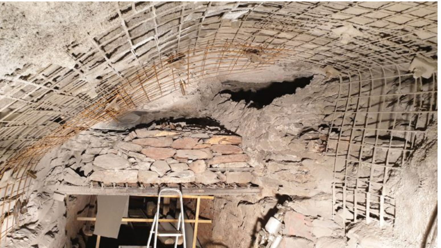
Sanierungsnotwendigkeit im Schlüsselstollen
