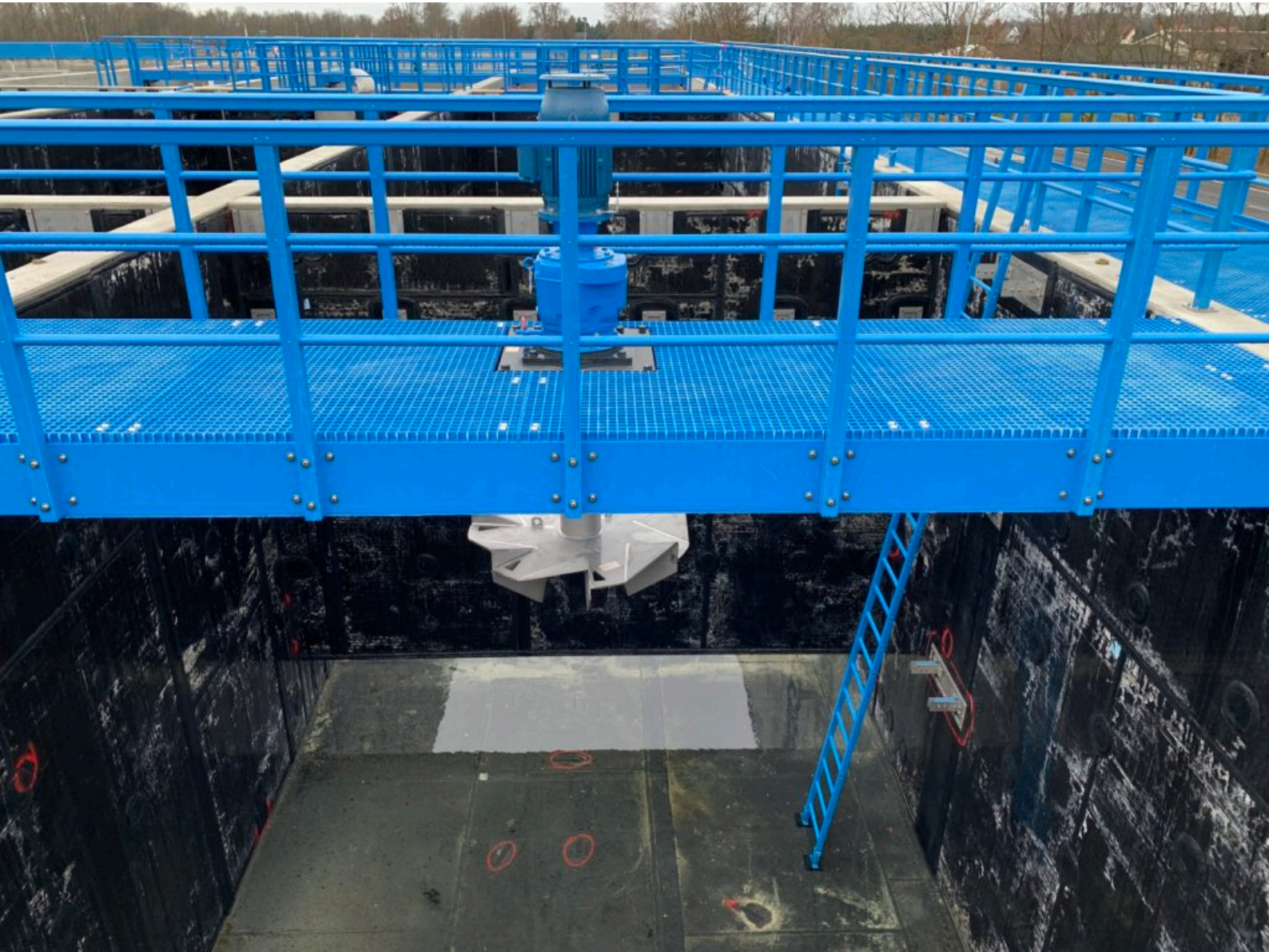
Rührwerk im Reaktionsbecken
