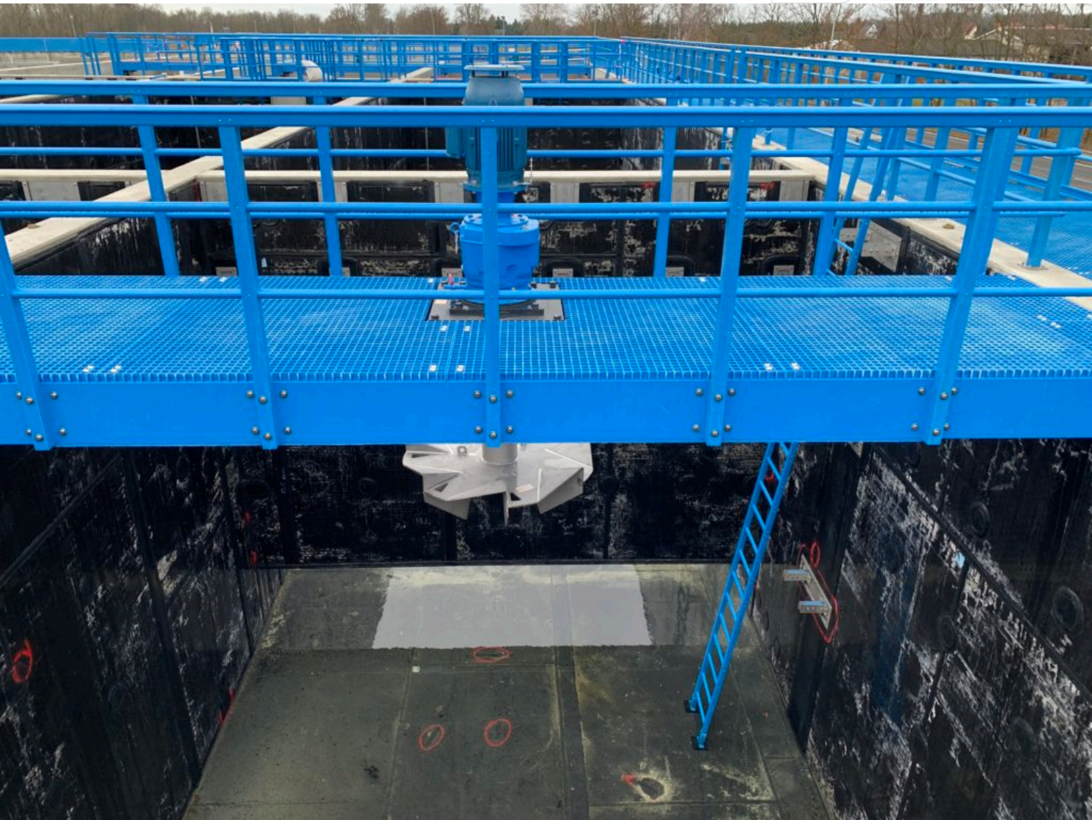
Rührwerk im Reaktionsbecken
