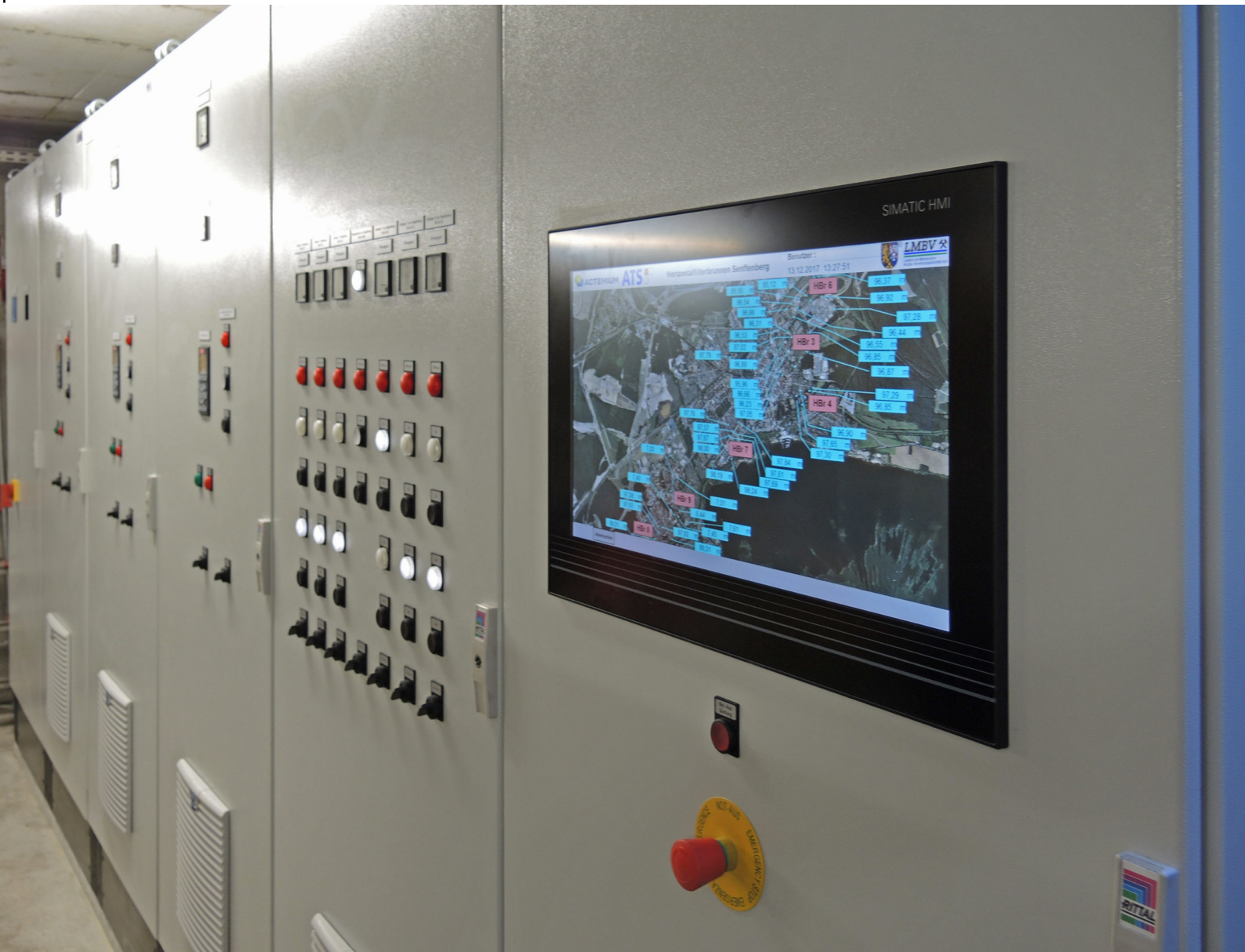
Brunnenstube: Steuerungseinheit des HBr 9 | Foto: S. Klein
