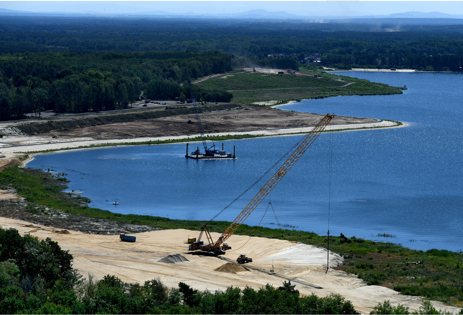
Landseitige und seeseitige RDV-Technik am Knappensee
