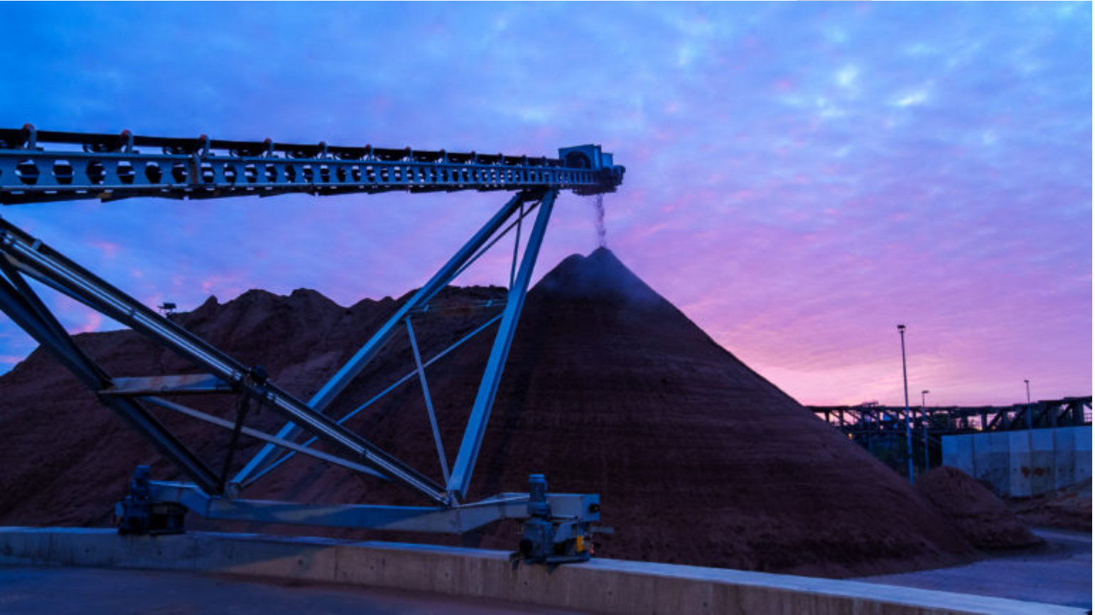
Abwurfanlage für gereinigten Boden
