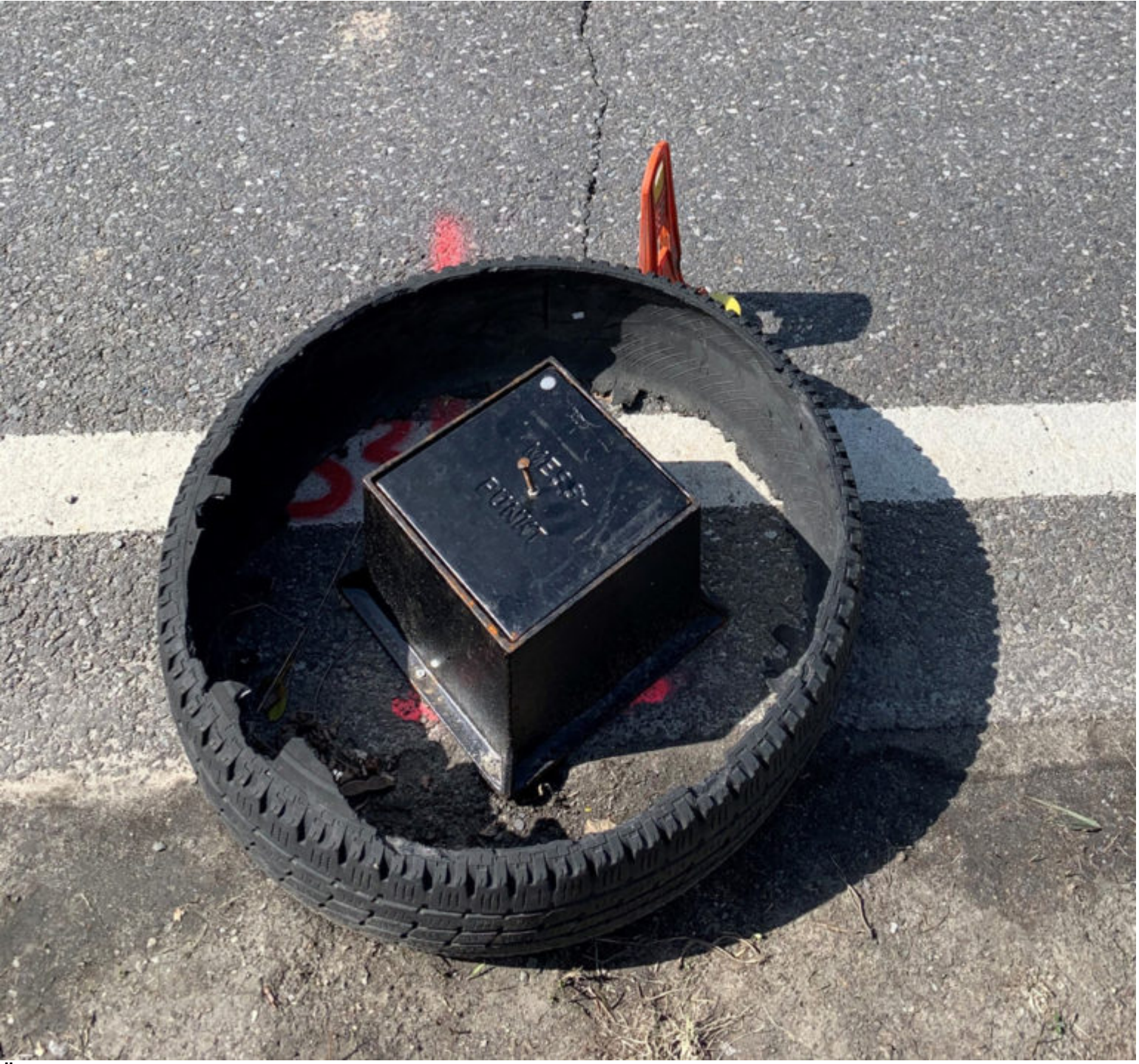
Überwachung des Risses
