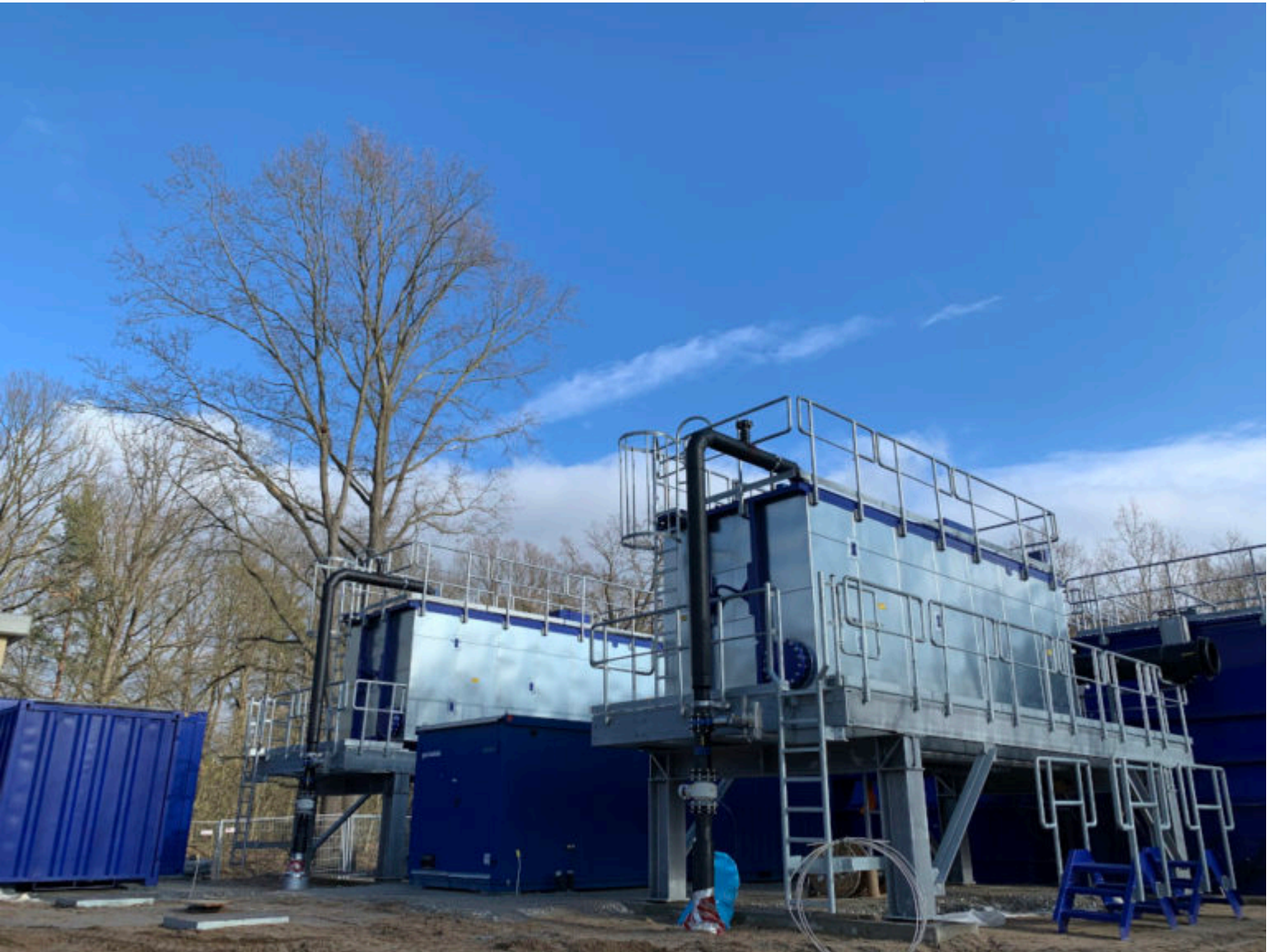
Flockungscontainer | MWBA Ruhlmühle
