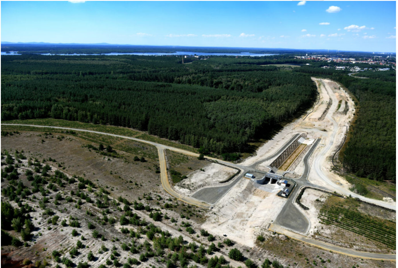
Hohe Anforderungen an die Flutungszentrale Lausitz: Vielfältige Stellhandlungen möglich
