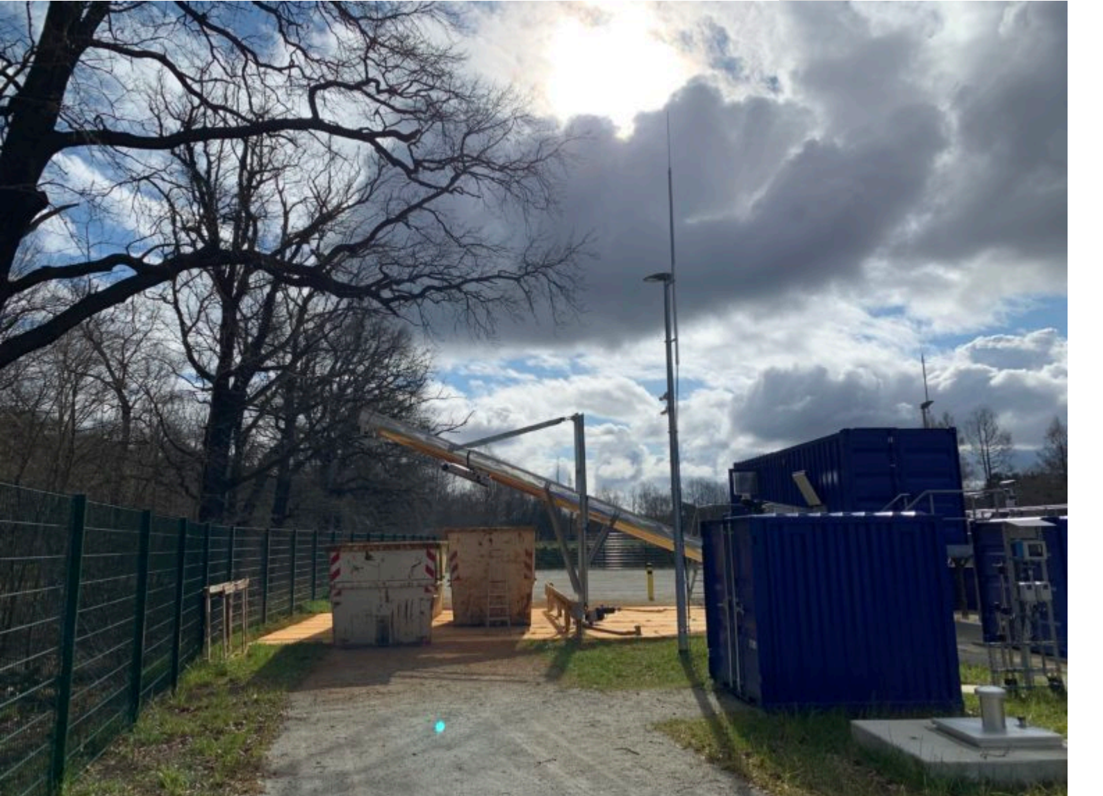
Der anfallende Eisenhydroxidschlamm wird in Containern aufgefangen und bspw. als Zuschlagstoff verwertet
