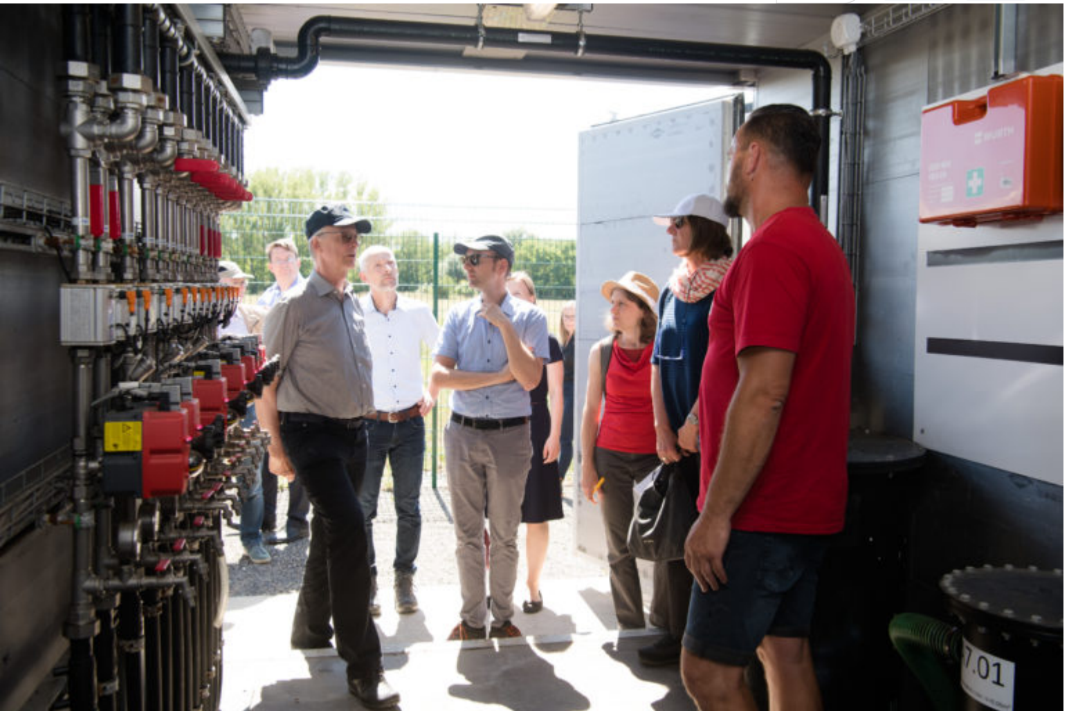
Fachaustausch zur Funktionsweise der Anlage.
