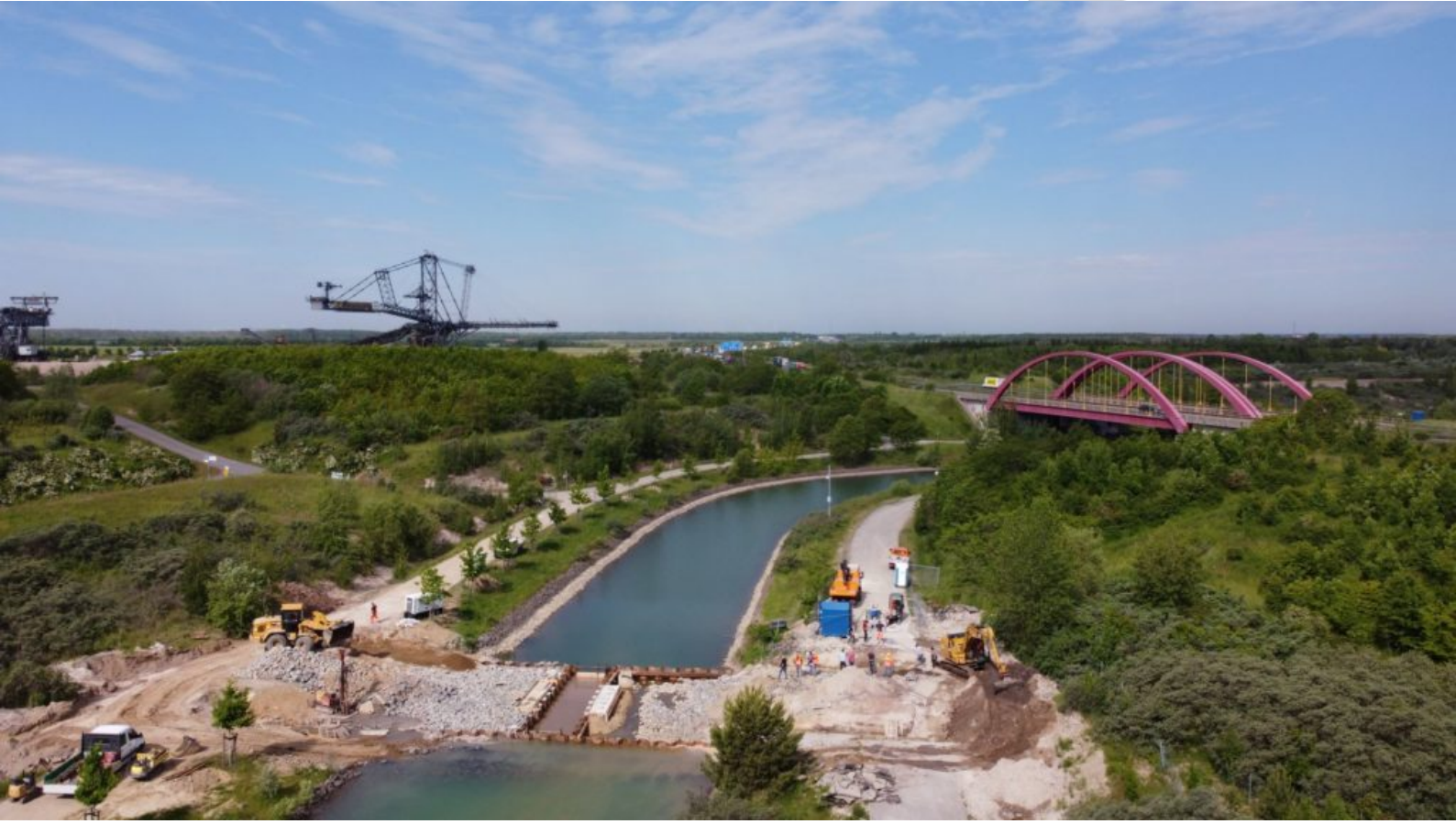
Das obere Querbauwerk ist fast fertig verfüllt, mit Wasserüberleiter in der Kanalmitte.
