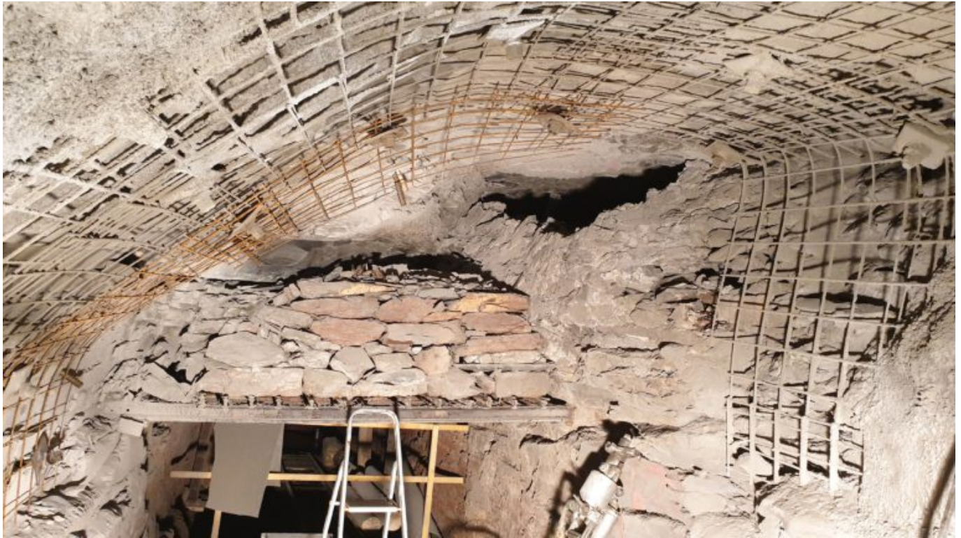
Sanierungsnotwendigkeit im Schlüsselstollen
