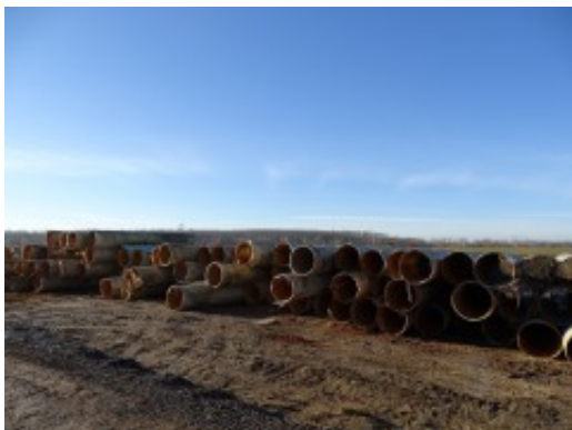
Schachtmeister Ralf Ludwig von Bickhardt Bau Thüringen zeigt die Rohre der Flutungsleitung.
