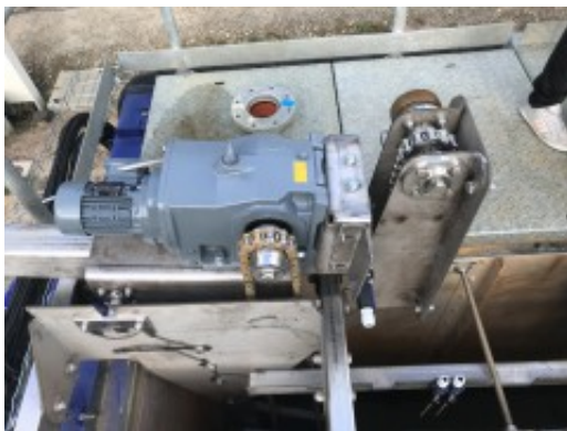
Die bisher häufig zugesetzten Schlammabzugsrohre in den Sedimentationscontainern werden durch eine Räumertechnik abgelöst
