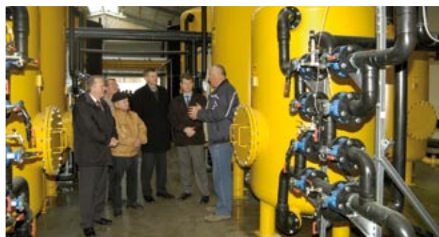
Wasseraufbereitungsanlage zur Senkung des Arsengehaltes
