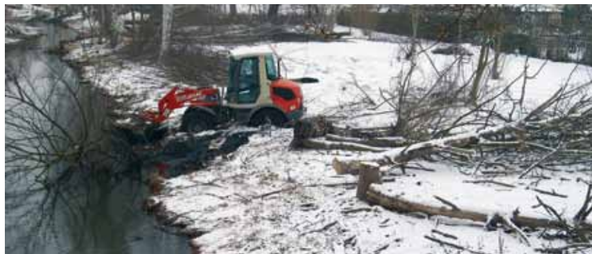
Für das Anlegen der Baustraßen entlang des Lobers ist das Fällen von rund 480 Bäumen erforderlich, für die nach Abschluss der Maßnahme ein Ausgleich erfolgt.
