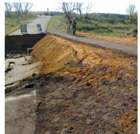
Radweg am Seelhausener See vor der Reparatur.
