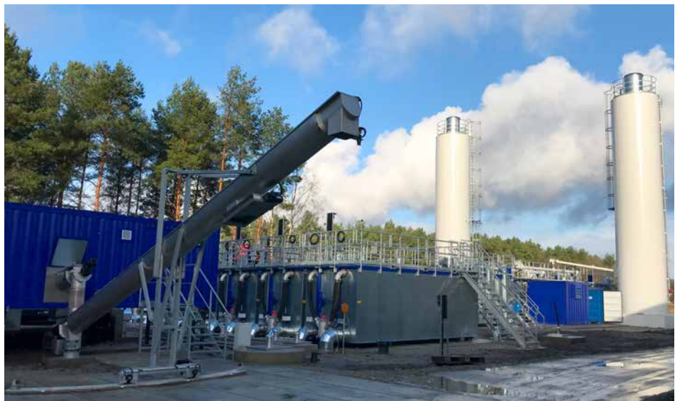
Die Mobile Wasser Wasserbehandlungsanlage Burgneudorf 2017 während der Errichtung – im Vordergrund die nicht mehr benötigten alten Absetzbecken
