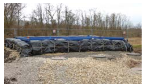
Die Wetland-Grundwasserreinigungsanlage soll ab Oktober 2018 zum Einsatz kommen.
