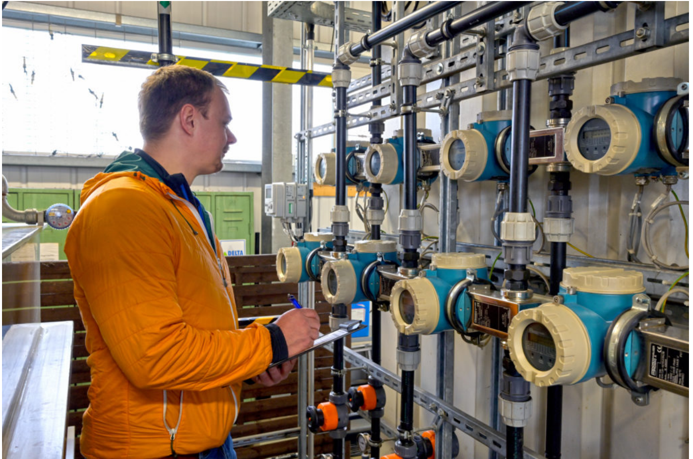
Dokumentation von Messwerten in der Grundwasserreinigungsanlage Zwickau/Schedewitz
