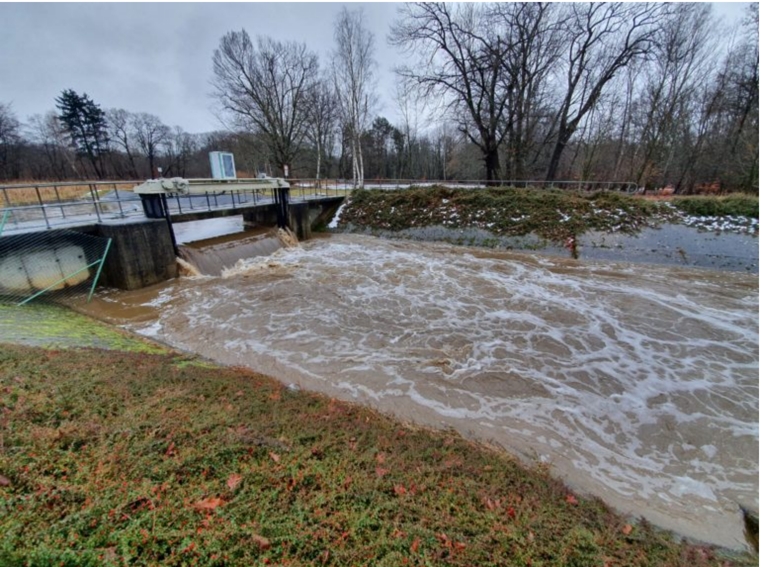
Geöffnete Zulaufanlage zum Speicherbecken Lohsa II am 04.02.2021 – 6,2 m 3 /s
