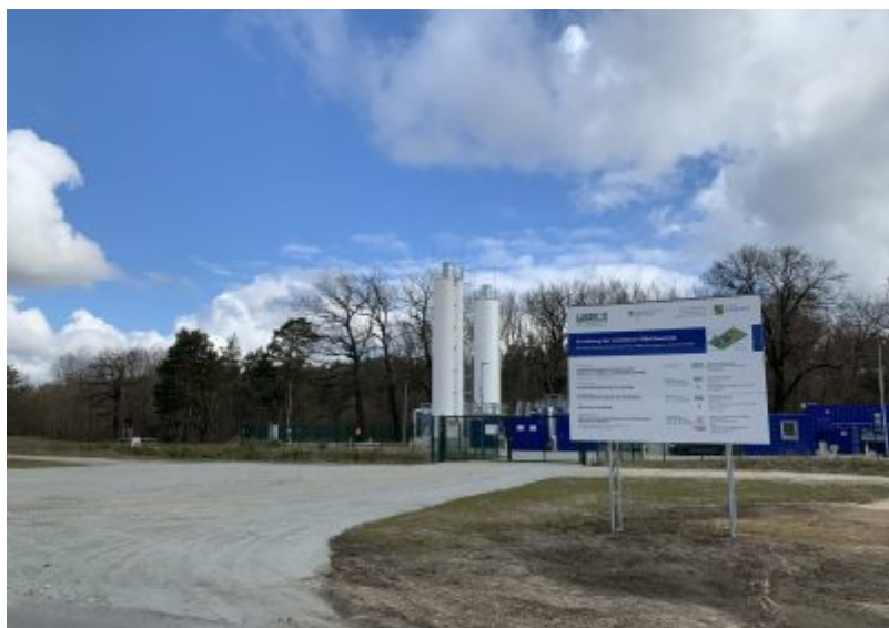
LMBV-Anlage bei Neustadt an der Spree
