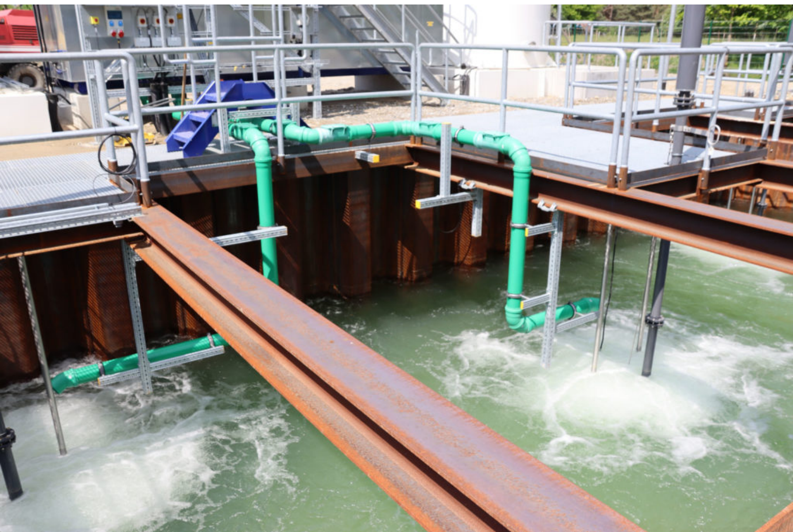
Inbetriebnahme des Reaktionsbeckens
