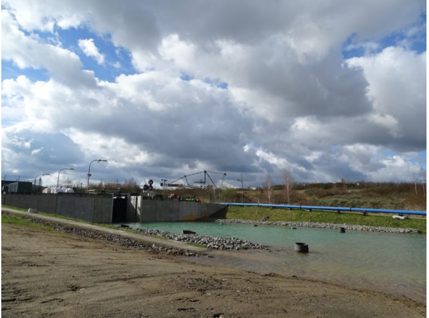
Bereich von Erosionen und Rissen am Störmthaler Kanal
