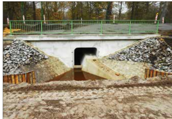
Durchlass unter der Calauer Straße mit einem Ottergang
