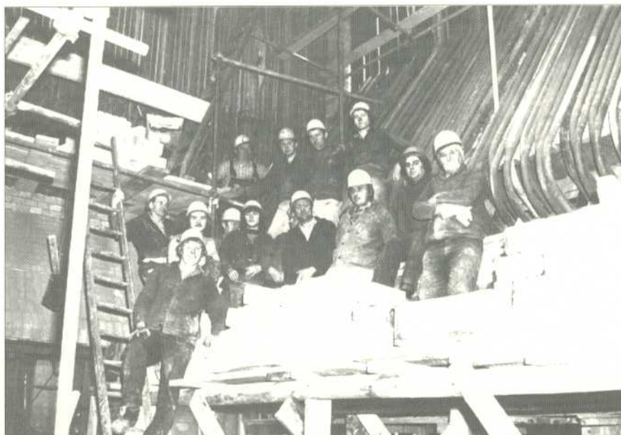
NEUAUFBAU DES DAMPFERZEUGERS 3 IM KESSELHAUS II NACH DER SCHWEREN HAVARIE IM MÄRZ 1977
