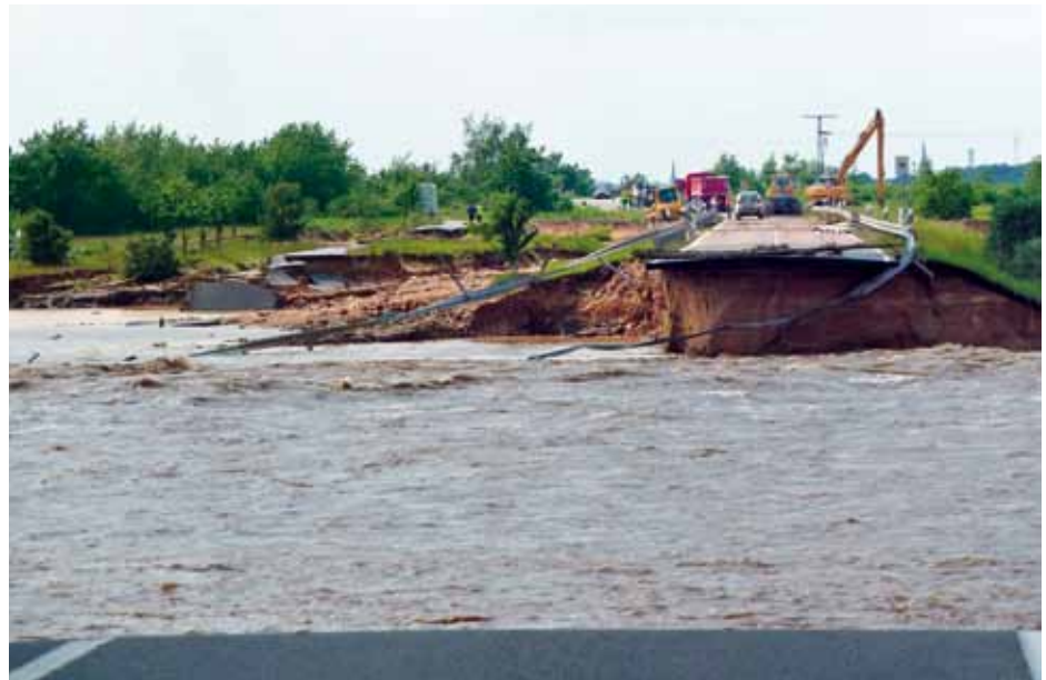
Beim Durchbruch des Muldewassers in den Seelhausener See wird auch die Infrastruktur mitgerissen.
