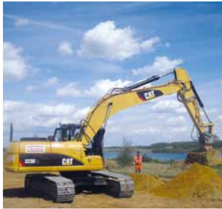
Kürzlich begann die Vorbereitung des Wegebbaus in Zwenkau im Bereich Großdeubener Weg.
