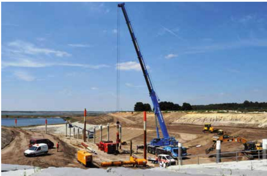
Blick vom Westportal auf die Bauarbeiten im Kanalbett zum Großräschener See und das Setzen der Dalben.
