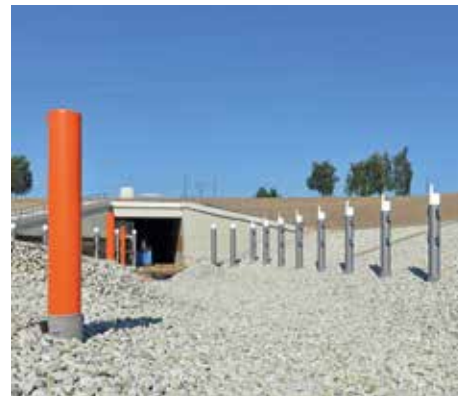
Tunnel- und Kanalbauwerk des Ilse Kanals (Überleiter 11) sind baulich fertig, liegen aber noch trocken.
