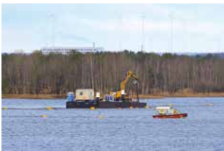
Beseitigung von Treibgut im Senftenberger See mit einem Bagger vom Schwimmponton aus
