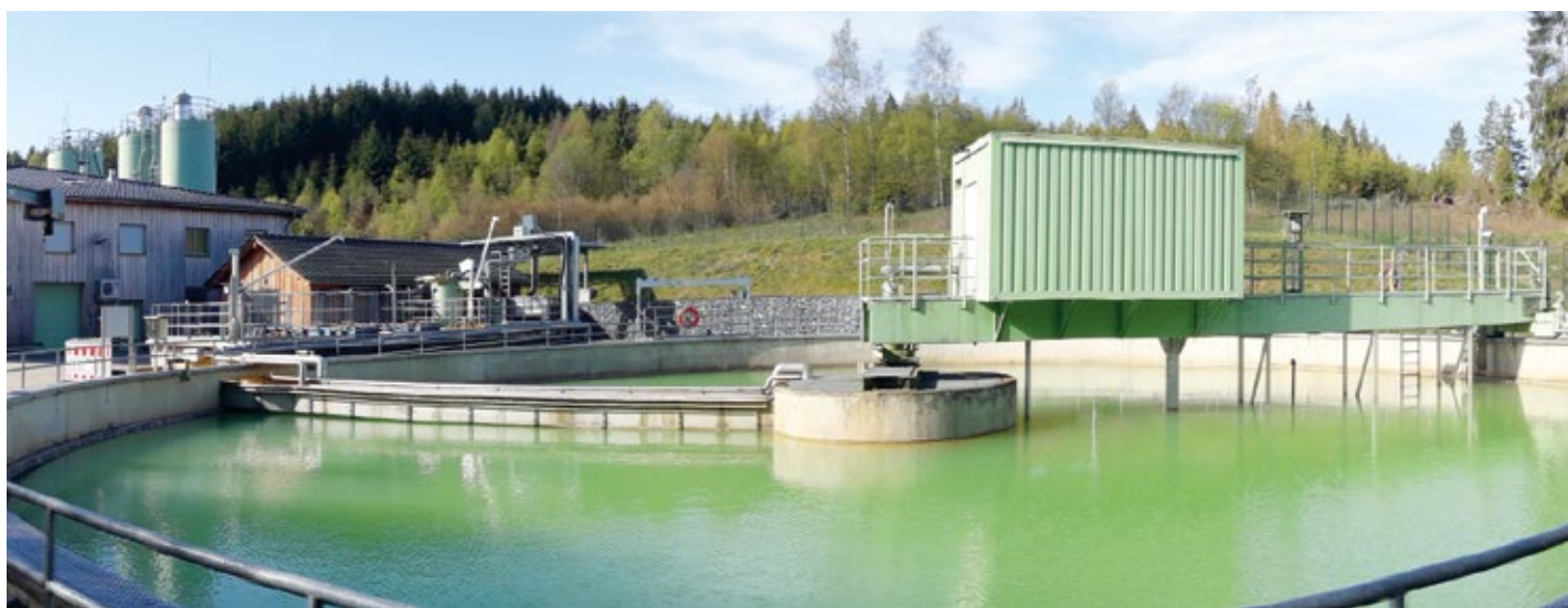
Die zentrale Grubenwasserreinigungsanlage Uhlenbach, in der das Grubenwasser von Eisen und Mangan befreit wird.
