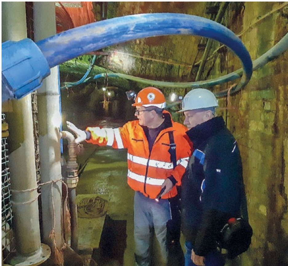
Projektmanager Uwe Rabe erläutert LMBV-Geschäftsführer Bernd Sablotny das Wasserhaltungssystem am Zentralschacht im Bergwerk Elbingerode.
