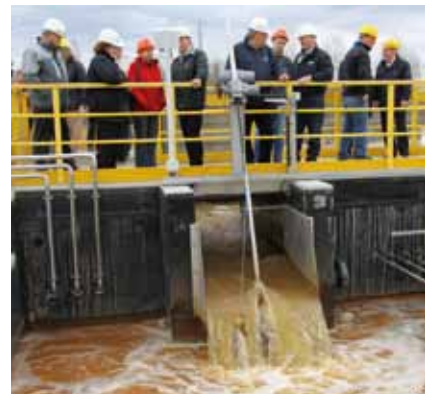
Pro Minute werden bis zu 60 Kubikmeter Grubenwasser in der Reinigungsanlage aufbereitet.
