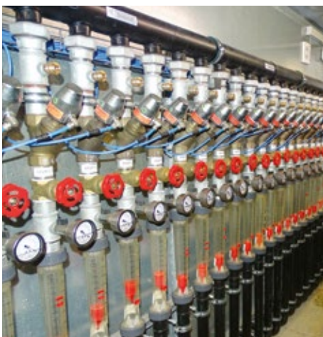
Blick auf eine Komponente der modernen Air-Sparging-Anlage
