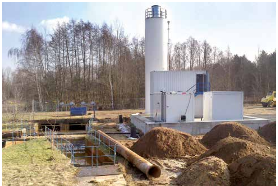
Neue Konditionierungsanlage an der Wasserbehandlungsanlage Vetschau
