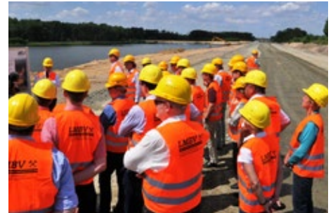
Aufmerksam folgen die StuBA-Mitglieder den Erläuterungen an der fast fertiggestellten Westböschung des Silbersees (Teil des Speicherbeckens Lohsa I).
