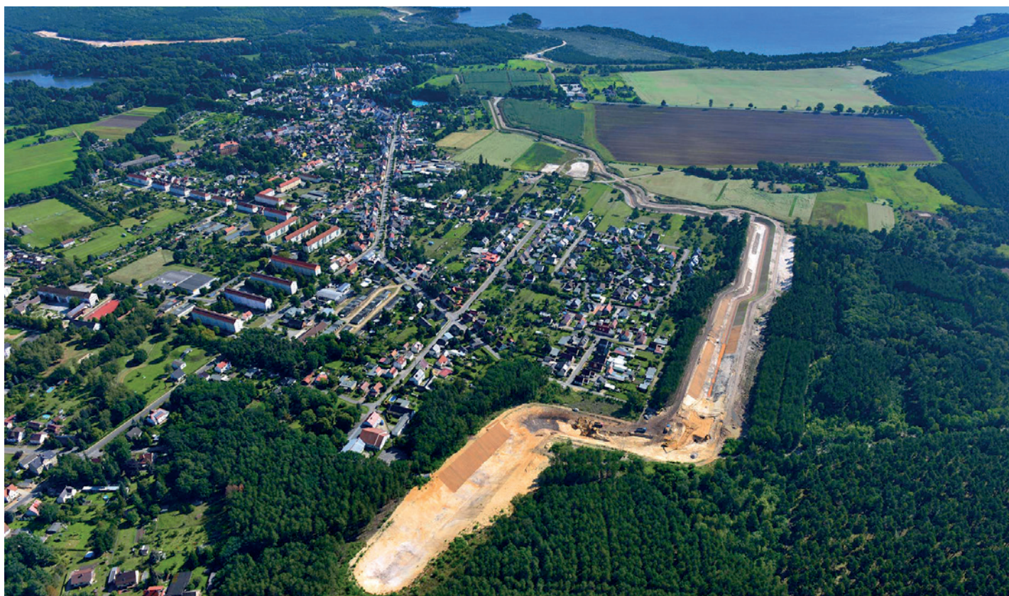
Die Baustelle des Südgrabens bei Altdöbern aus der Luft gesehen – im Hintergrund das Restloch des Tagebaus Greifenhain.
