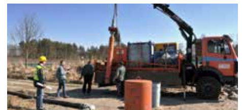
Das Herstellen der Vernetzung für eine automatisierte Gesamteinbetriebnahme der Pilotbrunnen und ihrer Ableitung war anspruchsvoll.
