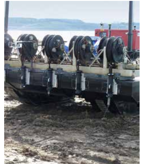
Für den noch niedrigen Wasserstand muss die Trittsicherheit mittels eines Amphibienfahrzeugs gesondert hergestellt werden.
